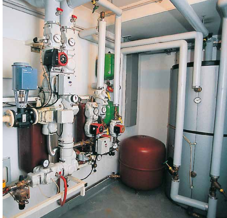
Fernwärmeversorgung in größeren Wohnanlagen.
