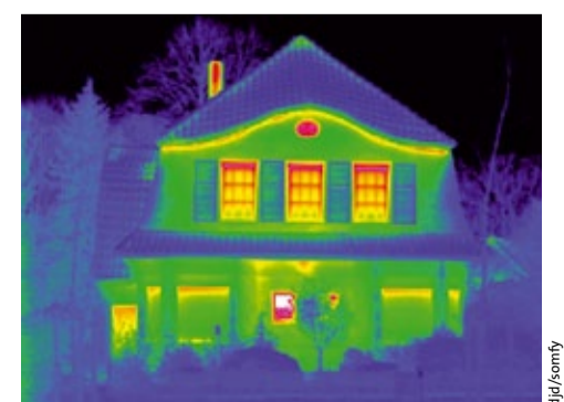
Ein Infrarotbild macht Wärmeverluste sichtbar: Im ersten Stock sind die Rollläden geöffnet, im Erdgeschoss sind sie geschlossen.
